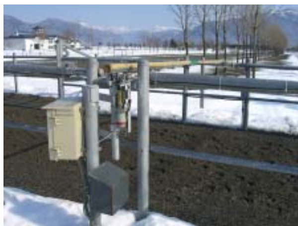
開閉バーと制御盤・バッテリー・電動シリンダー等
